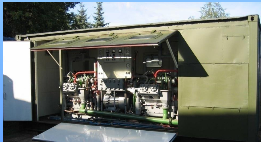
Общий вид компрессорного отделения
