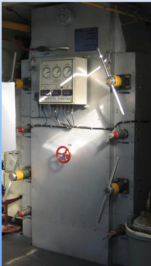
Блок осушки и очистки
