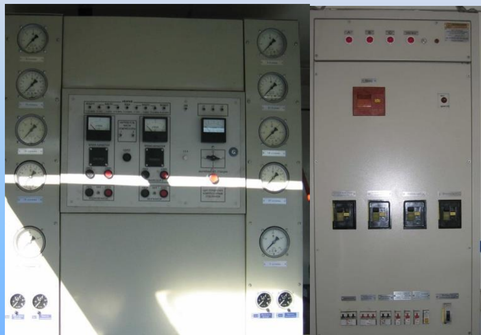
Щиты контроля и автоматики компрессоров
